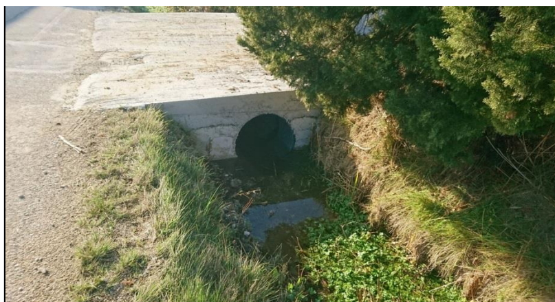
Figure 8 : Exemple d'ouvrage de franchissement à proscrire
